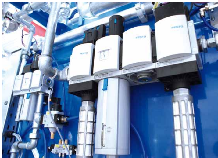
Eine Wartungsgeräteeinheit MSB9 übernimmt in Kombination mit der Ventilinsel VTSA die Sicherheitsfunktion „Schutz vor unerwartetem Anlauf“ in Performance-Level D.
