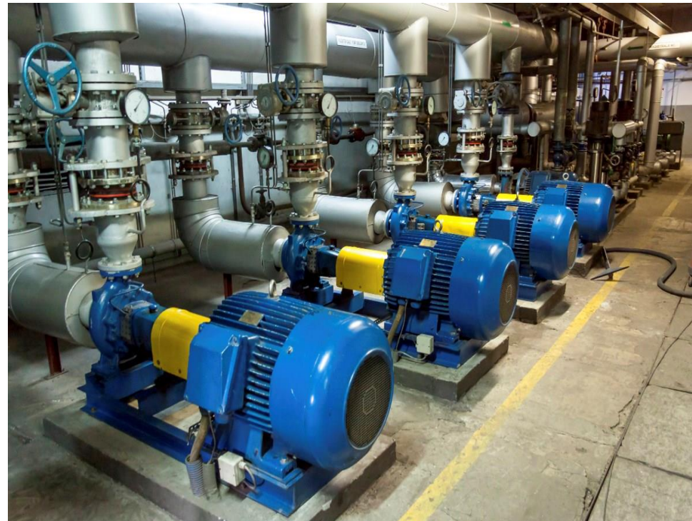
Pompes entraînées par moteurs électriques.
